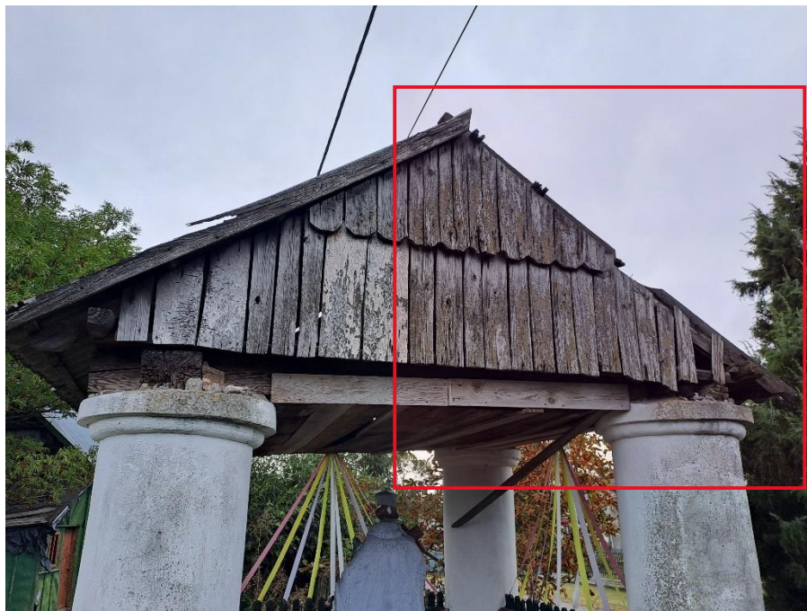
Osuchów, kapliczka św. Jana Nepomucena od strony zachodniej-widoczna destrukcja szczytu
