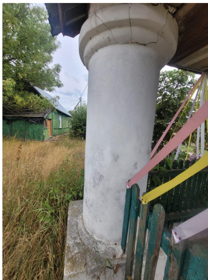
Osuchów, kapliczka św. Jana Nepomucena- widoczne spękania na kapitelu kolumny płn. – wsch.
