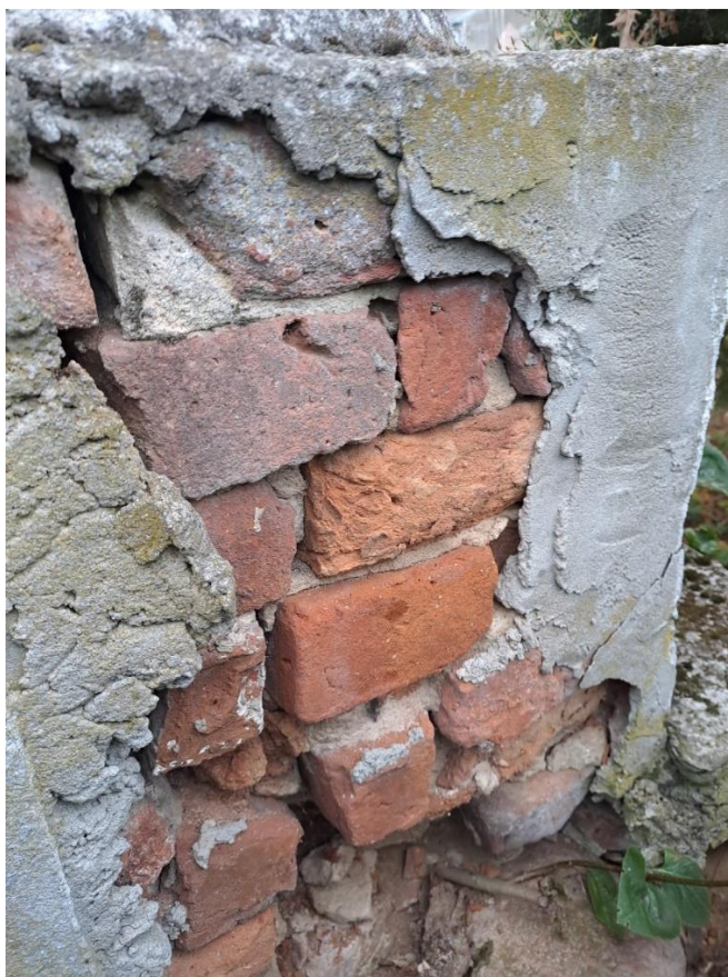
Osuchów, kapliczka św. Jana Nepomucena- widoczna destrukcja cokołu kolumny płd.-zach.
